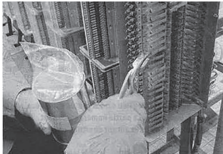
Intervention sur un parafoudre.
