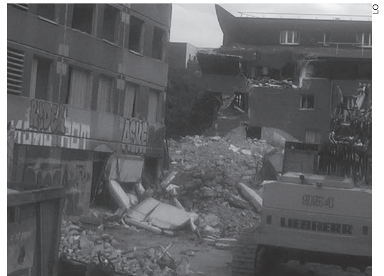
La cité éventrée par l'effondrement de la barre.
