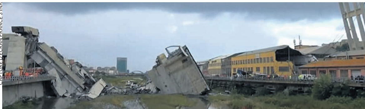
L'effondrement du viaduc de Gênes en 2018.
