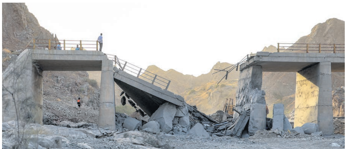
Un pont détruit par les bombardements américains, entre Roudan et Bandar Abbas dans le sud de l'Iran, le 18 juillet.
